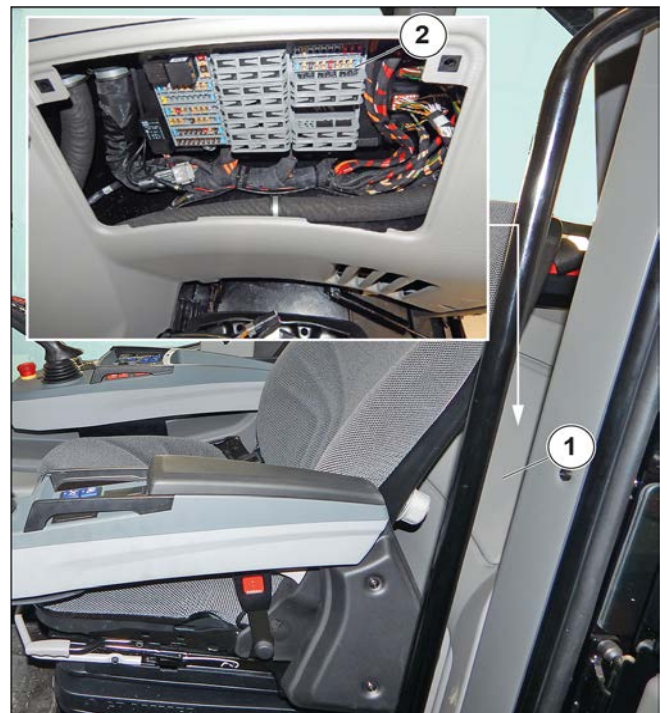
Afbeelding 214: Zekeringen en relais in cabine
