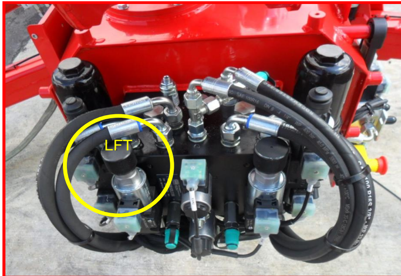
Figure 22 : vanne gauche du banc de filtres.
